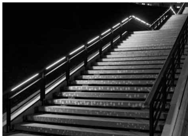
Илл. 4.1.18. ОБОРУДОВАНИЕ ДЛЯ ОСВЕЩЕНИЯ ОРГАЖДЕ-НИЙ И ЛЕСТНИЦ
